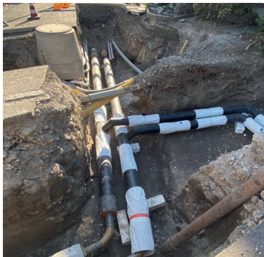
Fernleitung im Bereich Einmündung Bühlstrasse mit Abgang zum Areal Gärbi (Bildmitte rechts).
