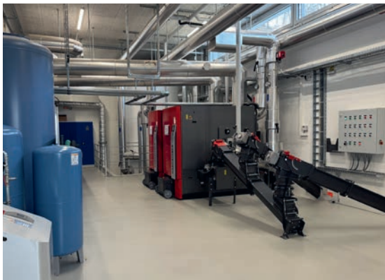
Heizzentrale mit zwei Heizkesseln à 330 kW in Betrieb inkl. Platz für einen dritten Kessel.
