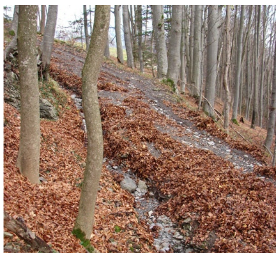
Die häufigen Gewitter hinterliessen Spuren an den Naturstrassen. Grabus unterhält im Auftrag der Ortsgemeinden Grabs, Buchs und Sevelen über 100 km Wald- und Alpstrassen.
